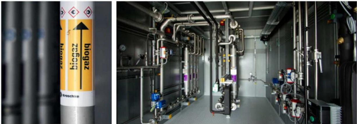
Ryc. 11 Przykładowa szafa sterownicza źródło: agriKomp Polska
