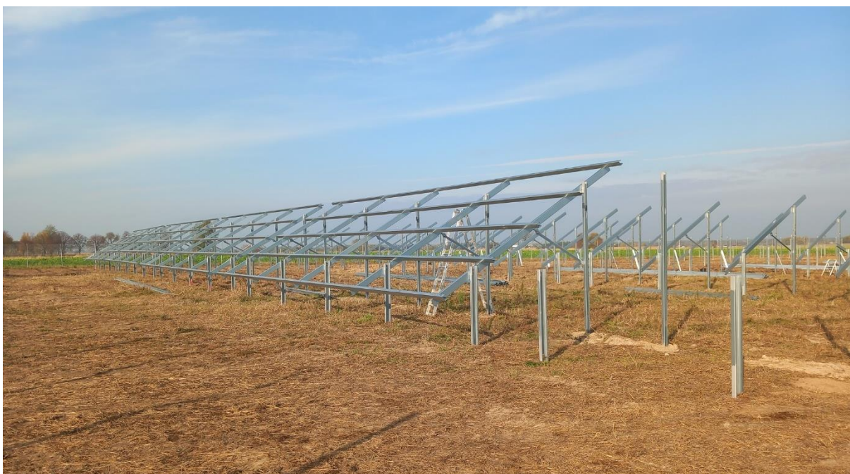
Fot. 7.2.1-2: Metalowe stelaże pod moduły fotowoltaiczne
